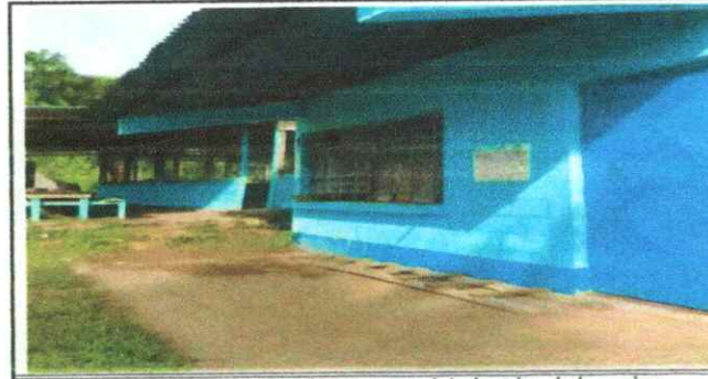
Foto 6: Se observa las puertas inseguras y deterioradas de la cocina.
