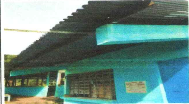
Foto 2: Se observa ventanas en malas condiciones.
