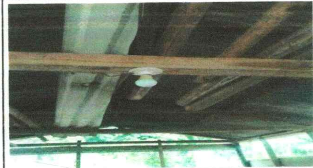
Foto 4: Se observa las costaneras en mal estado de la cocina
