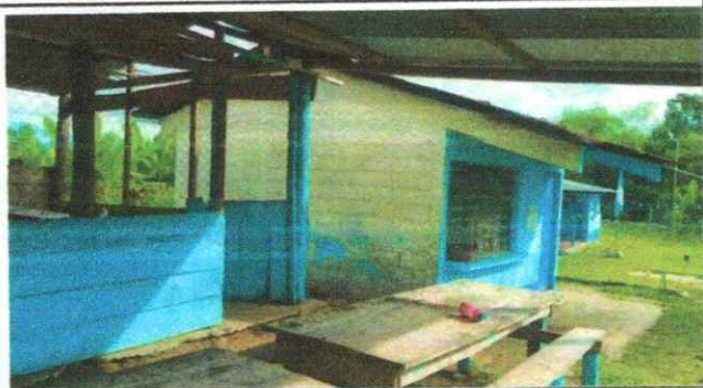
Foto 1: Se observa la pared de la cocina deteriorada.
