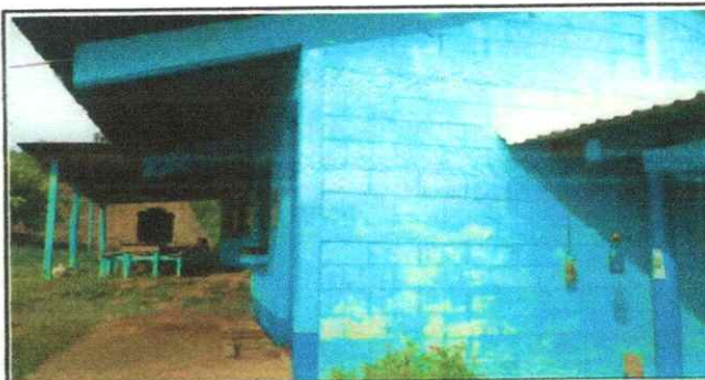
Foto 5: Se observa el techo deteriorado de la cocina
