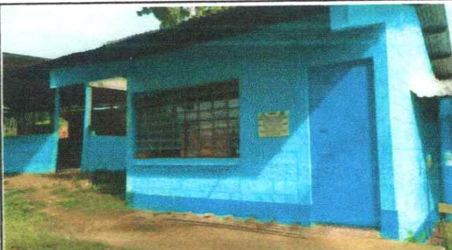
Foto 3: Se observa el piso de la cocina deteriorado
